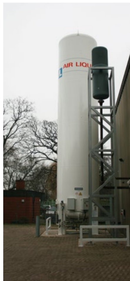
Der Außentank neben der Halle
